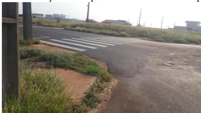
Imagem 04 – Avenida das Nações: situação do asfalto em uma das principais vias local
