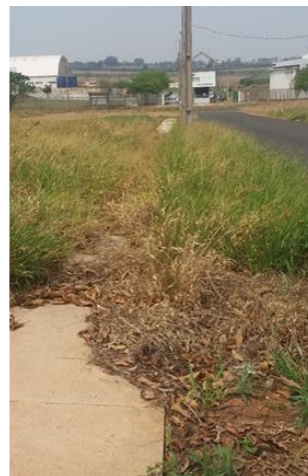
Imagem 06 – Calçada sem manutenção - inacessível devido à invasão de vegetação
