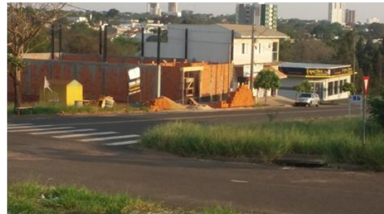
Imagem 08 – Calçada sem acessibilidade devido ao material de construção
