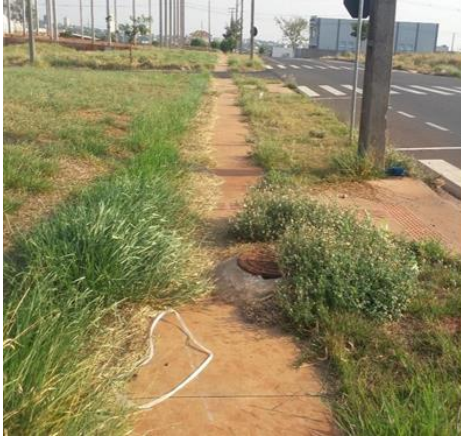
Imagem 07 - Calçada sem manutenção com acessibilidade comprometida
